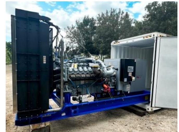
Tijdelijke gecontaineriseerde gasgenerator
