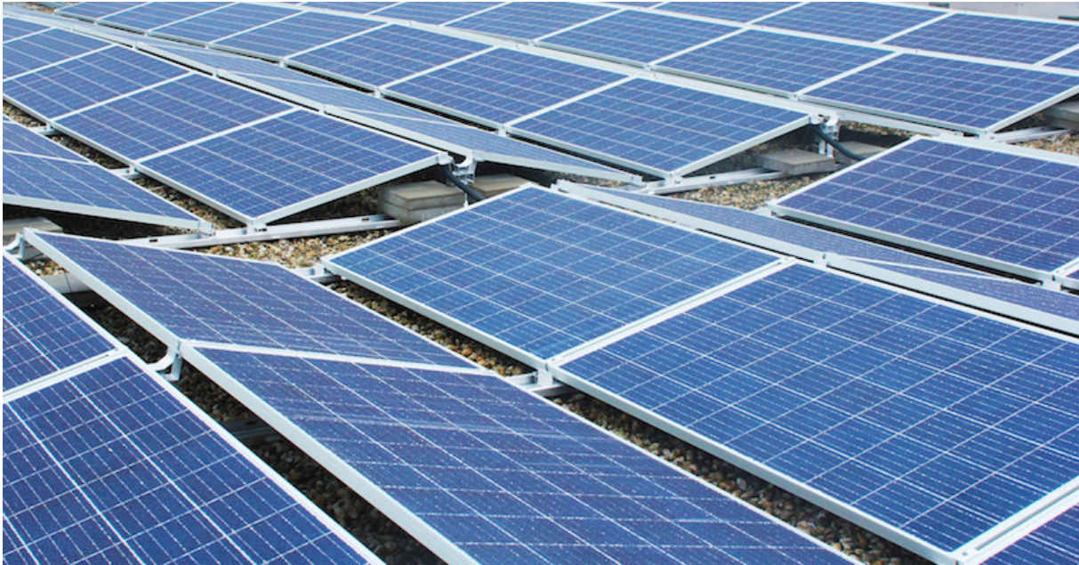
Zonnepanelen met oost-west oriëntatie – bron: NP RES
